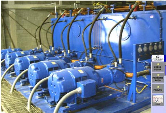
3000 ton press power unit
